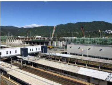
新幹線の新敦賀駅の工事中。今しか見ることのできない絶景だ
